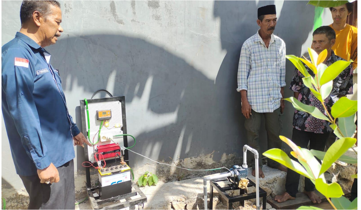
Gambar 5 Ketua Tim PMP menunjukkan kepada masyarakat Instalasi Tenaga Surya dan Pompa Air )
